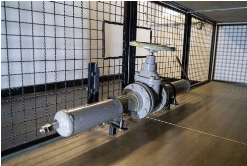
Abb. 17: Ventil in der Atemschutzübungsstrecke
